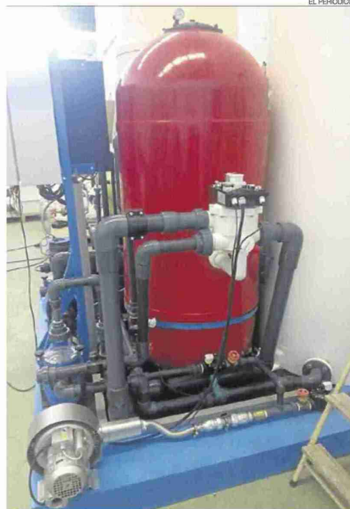
► La desnitrificación biológica se hace mediante un filtro poroso.
